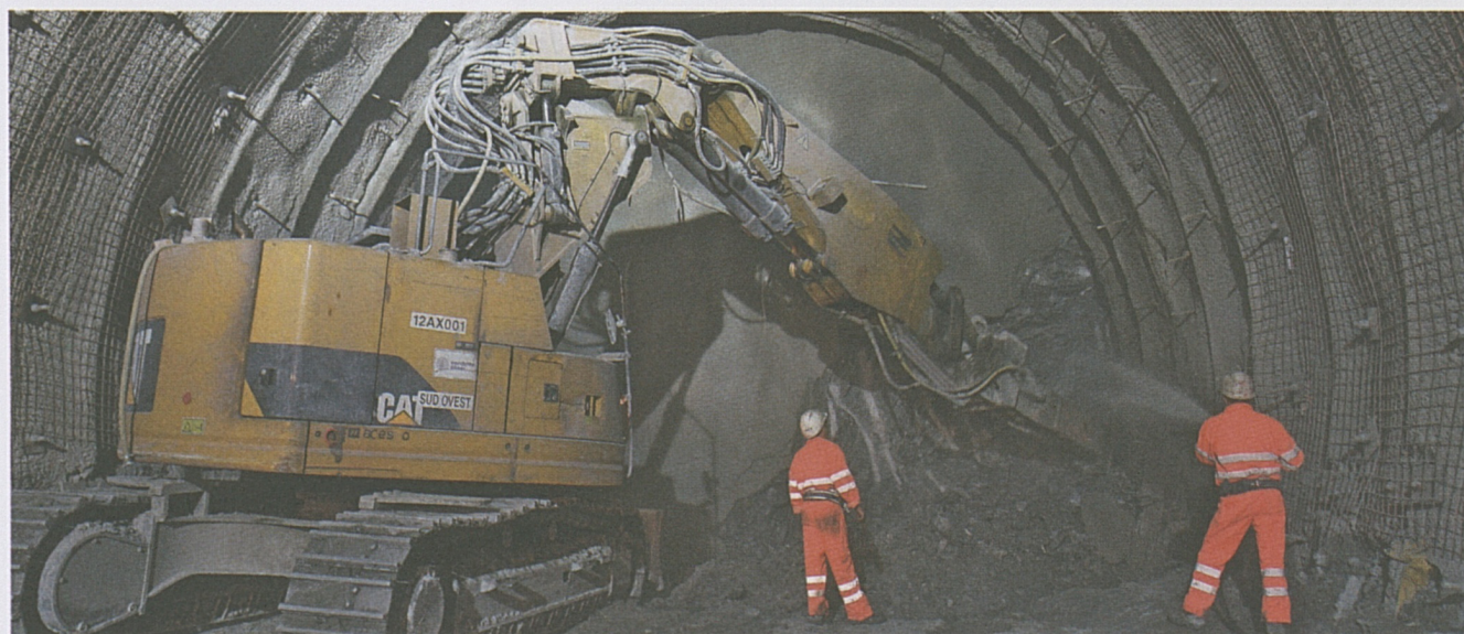
Sopra: deposito definitivo del materiale. Sotto: avanzamento con martellone nella zona geologicamente disturbata della linea della Valcolla
