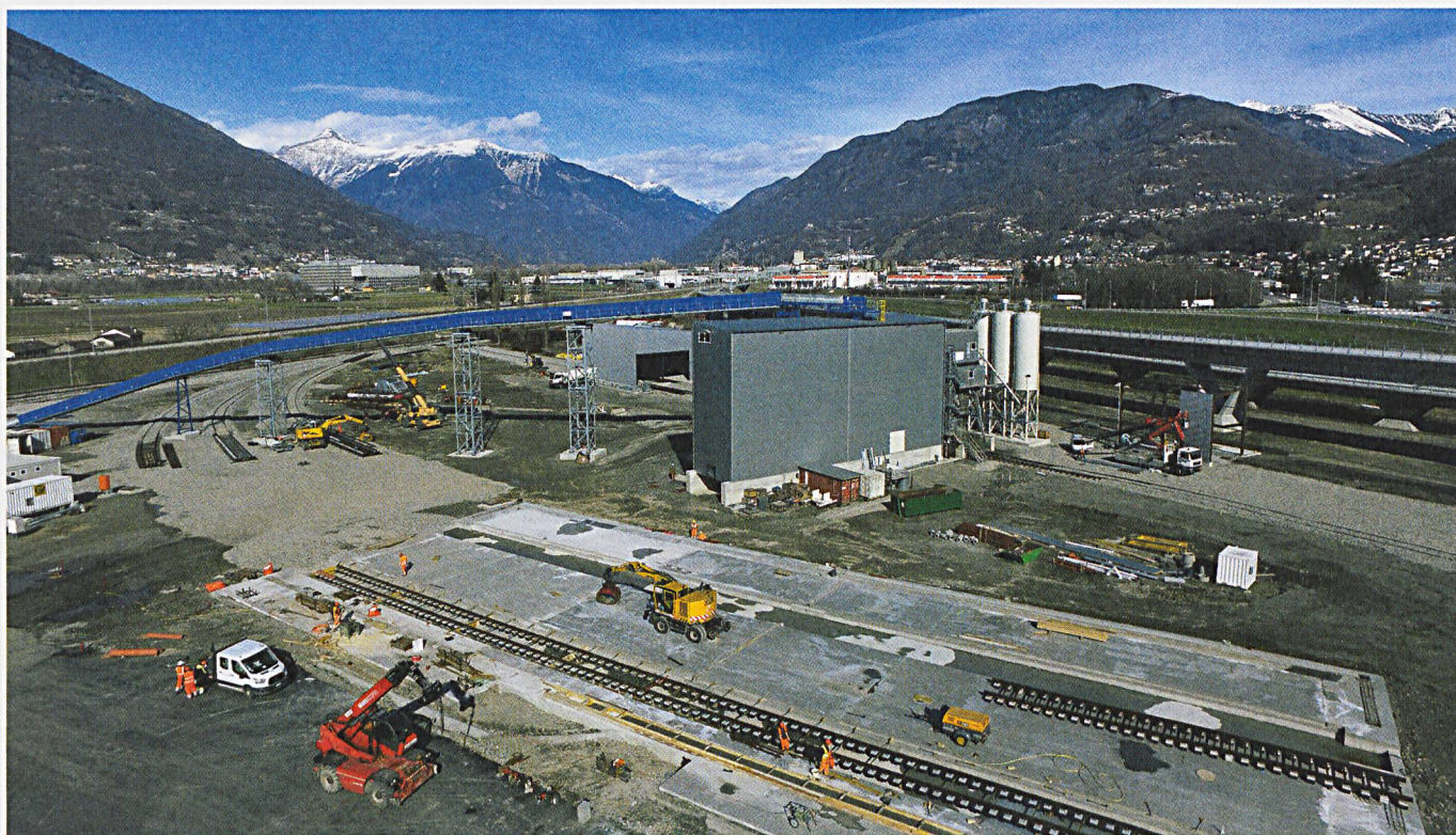
Camorino, piazzale d'installazione della tecnica ferroviaria
