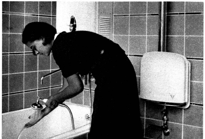
Calorifère et chauffe-bains automatique.
