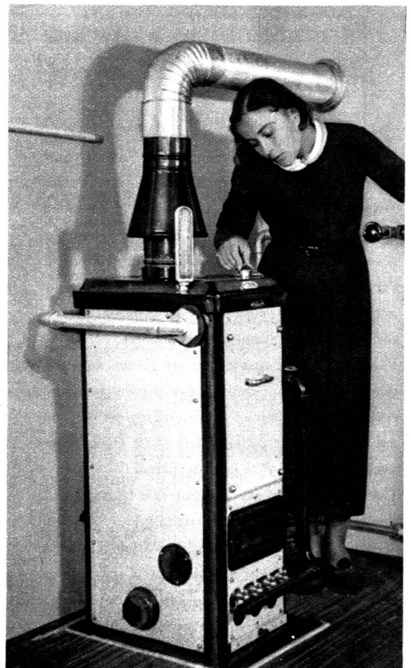
Chaudière de chauffage par étage au gaz.
