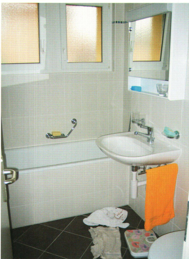
La Colosa a privilégié pour les aménagements intérieurs des matériaux suisses d'entretien facile.
