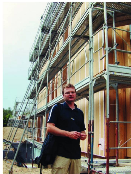
Ralph Thielen, pilote du projet, devant l'immeuble en construction, début juillet 2009. © Vincent Borcard
