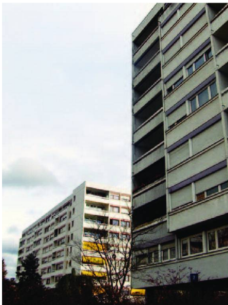
Des rénovations doivent être entreprises sur les grands locatifs de la Cité Vieusseux.
