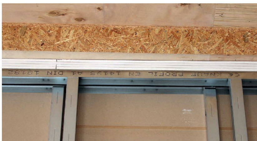
Raccord au plafond décollé sur le plan acoustique, plus cloisons de séparation à double ossature et Silentboard, également dans des locaux industriels.
