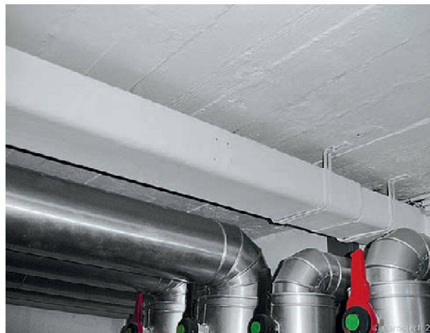
Avant 1990, l'amiante servait aussi d'isolant pour les tuyaux.
