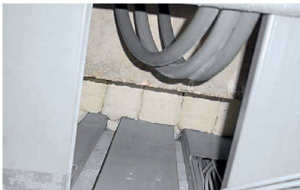
Interdit depuis 1990, l'amiante se trouve encore dans des immeubles construits avant 1990: ici, pour isoler la tuyauterie.
