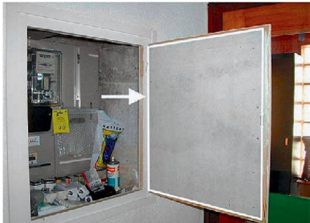
L'amiante permettait notamment d'isoler les portes des tableaux électriques.
