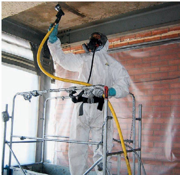
Seule une entreprise spécialisée est habilitée à effectuer des travaux de désamiantage.
