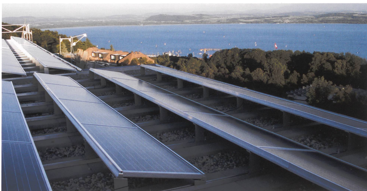
Le toit de l'immeuble des Acacias est recouvert de panneaux solaires photovoltaïques et thermiques depuis 2010. © Coopérative Les Rocailles
