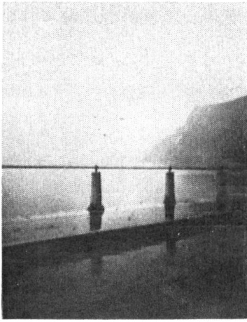
27. Geländer bestehend aus rundem Granit-Wehrstein mit obenliegender Eisenrohr-Verbindung. Kinder- und Kinderwagen sind gefährdet. (Axenstrasse.) Nicht vorbildlich.
