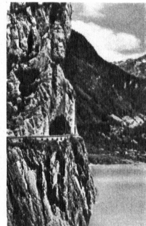
25. Alte Parapettmauer mit Schneelöchern. Ansicht vom See her. (Axengalerie.)
