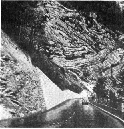
4. Die Maueroberkante sieht nach reissbrettartiger Linienführung aus und steht im Gegensatz zu der geologisch interessanten Faltung der Kreideschichten im Hintergrund. (Südlich Axengalerie.)
