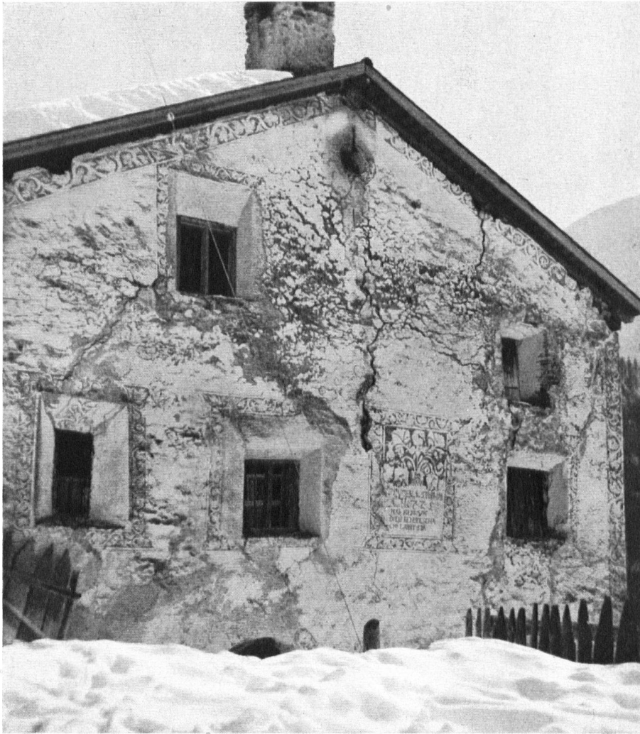
Haus Stupam (Westseite). Einst ein stolzer Giebel mit reichem Sgraffitoschmuck, heute dem Zerfall nahe. Auch dieser Bau soll wiederhergestellt werden.
