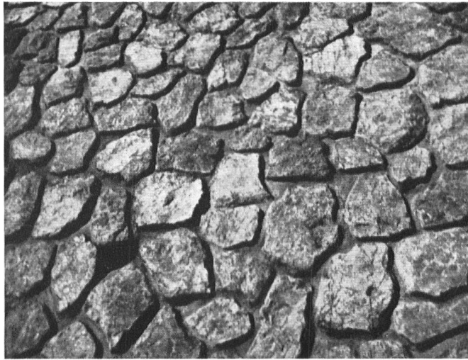
Mauerwerk aus Dolomit von 1934 bei Reichenhall; pflasterartig mittels Zement zu „Zyklopen“-Mauerwerk zusammengeklebt.
