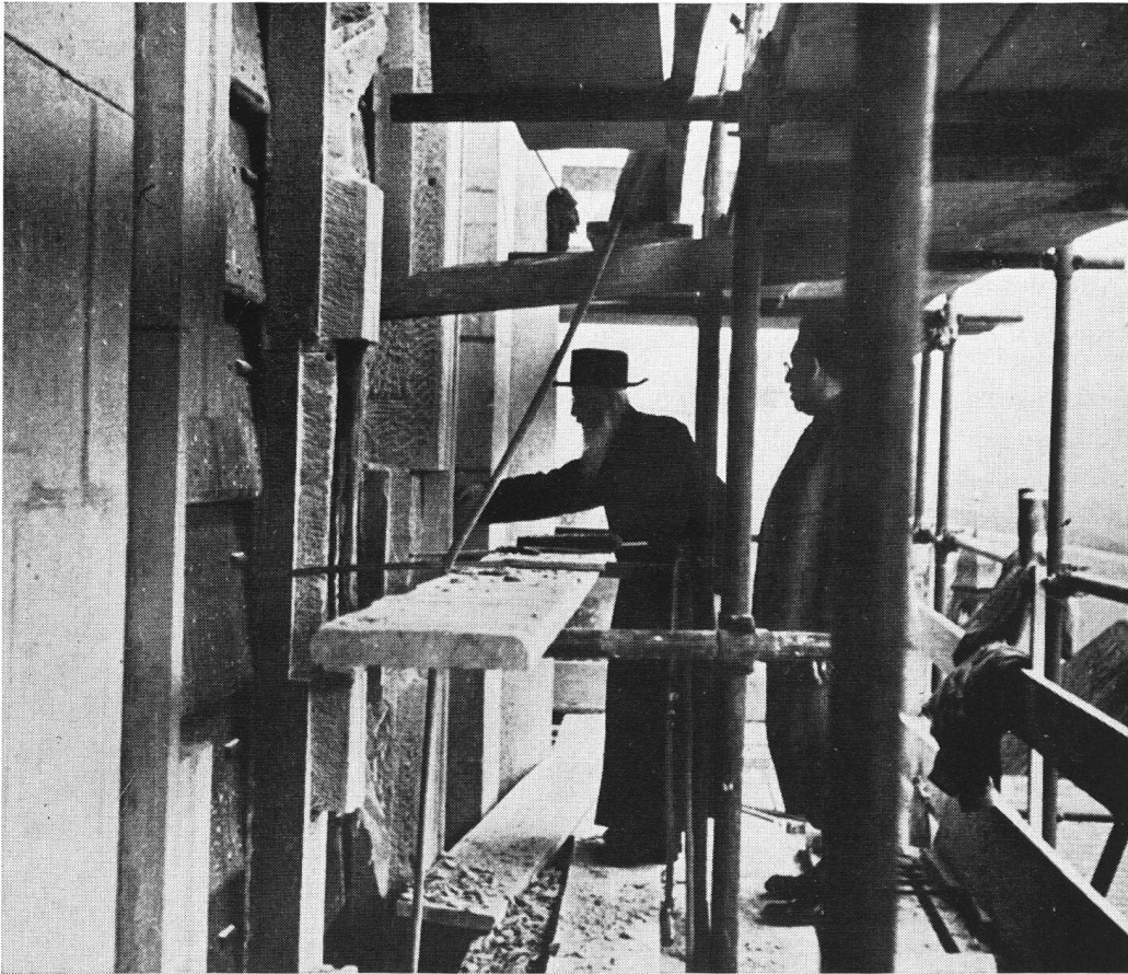
Eglise abbatiale d'Einsiedeln (1719 à 1726), façade ouest. Baie de l'étage supérieur de la tour nord (1949). Les parties atteintes des pans de mur et du pilier central ont été ravallées; elles ont été remplacées par une application de plaques d'épaisseur insuffisante.
