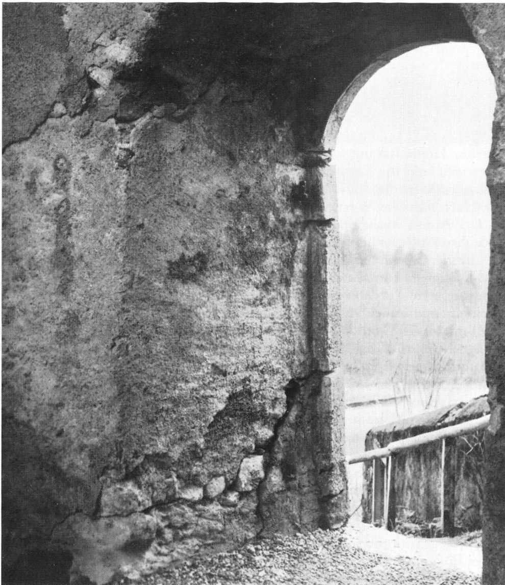
Stadtforte im Süden, durch die man über einen reizvollen Pfad auf die Weiden am Berg- hang hinabsteigt. Auch die brüchig gewordene Stadtmauer verdient es, gefestigt und erhalten zu werden.
