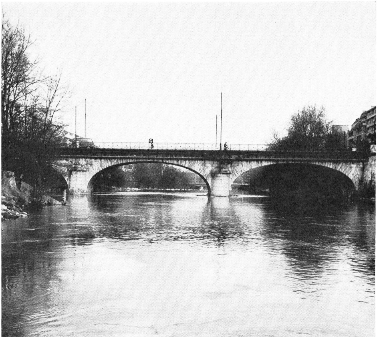
Le Pont-Neuf; construction décidée à la demande des Carougeois par Bonaparte, lors de son second passage, au début du XIXe siècle; en rapport avec l'ouverture de la route du Simplon. Les travaux, commencés vers 1810, s'achèvent en 1817. Elargi après 1860. Les arcs sont établis sur un tracé à plusieurs foyers. Il faut souhaiter la conservation de cet ouvrage.
