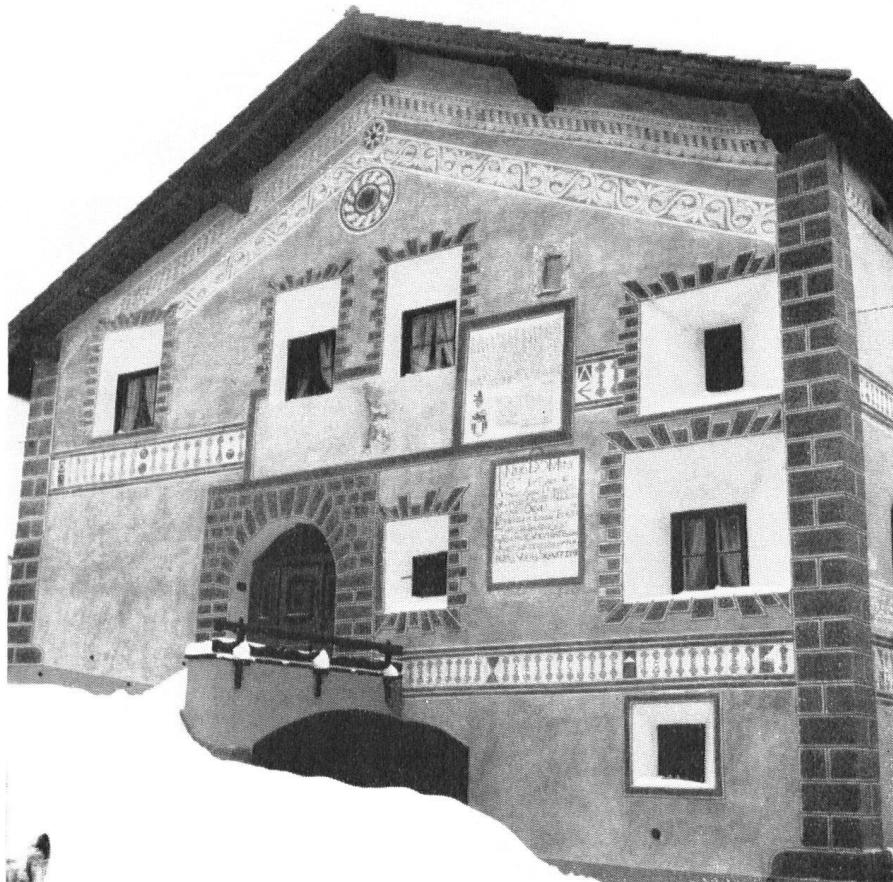
Dank äußerster Anstrengung des Eigentümers, einem Zuschuß des Heimatschutzes und dem feinfühli- gen Verständnis des Restaurators C. Könz in Zuoz ist aus dem markanten Bau, der an der Fassade über reiche Sgraffiti verfügt, ein Schmuckstück der Gemeinde geworden.
