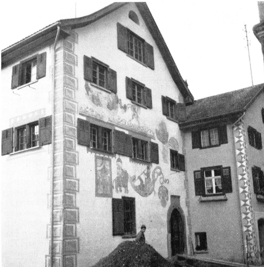
Nach jahrelangen Bemühungen ist es dem Bündner Heimatschutz und der kantonalen Denkmalpflege gelungen, das Haus zu restaurieren und in seinem früheren Zustand zu erhalten.
