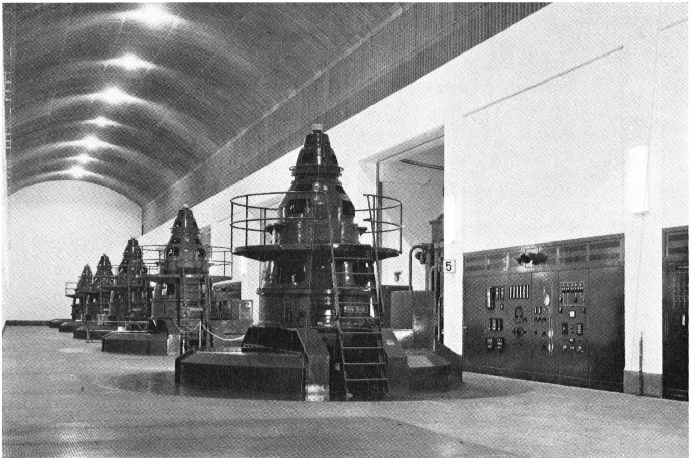
Un bon nombre de centrales, pendant et après la guerre, ont été logées en de spacieuses cavernes. Ici, celle d'Innertkirchen dans l'Oberhasli BE.
