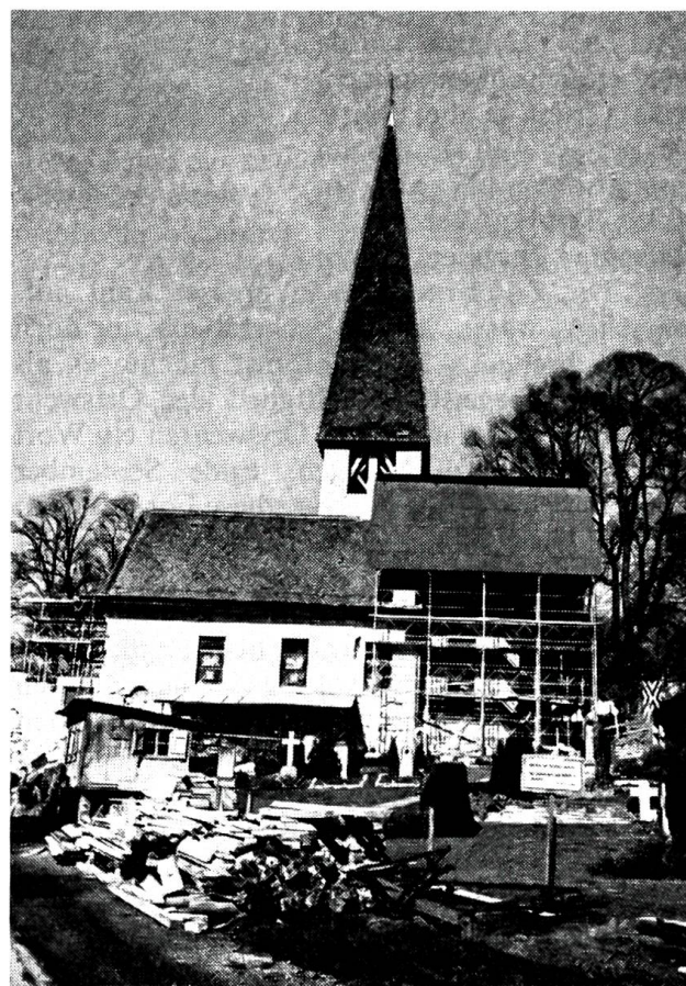
Neuer Turm für die Kirche Muri bei Bern. Er ersetzt den baufällig gewordenen, 1881 vom Grafen von Pourtalès geschenkten, in neugotischem Stil gebauten Turm.
