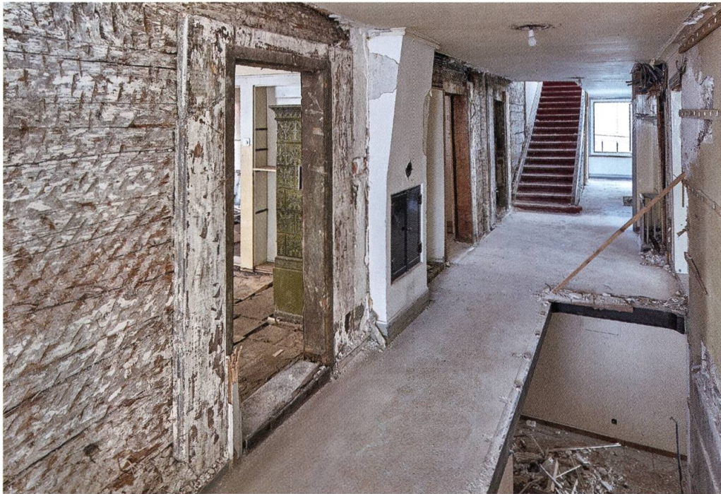
Abb. 4: Flüelen, Axenstrasse 2. Mittelgang. Blick gegen Süden. Die Türöffnungen sind mit Mantelstüden versehen, die Wandflächen des Ganges waren vermutlich bauzeitlich weiss getüncht. Zur Anbringung eines späteren Verputzes wurden die Oberflächen gekerbt (Foto: Georg Sidler, Schwyz).
