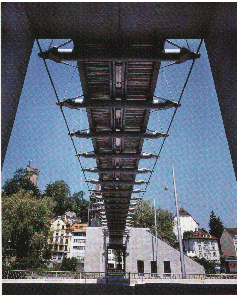
Untersicht der Brücke. Spiralseile der Bogenaussteifung, Hängeseile, Quer- und Längsträger, Beplankung zeigen die Klarheit des Kräftespiels
