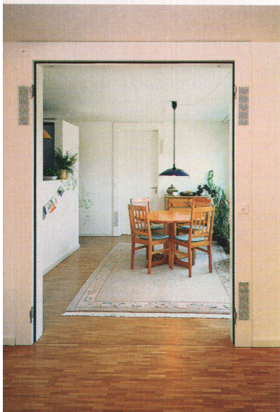
In der Türzarge sind Quellausslass, Abluftdurchlass, Lichtschalter, Steckdosen und Telefonanschluss integriert
