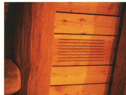
Hinter der Deckenverkleidung aus Rundhölzern ist die Lüftung versteckt
