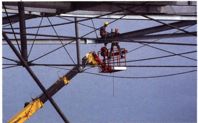
Yverdon – der Ort der Sorgen – ist der spannendste Bauplatz der Expo.02. Im See entsteht der Träger der «Wolke». 12 500 Düsen oder 31 000 Düsen? Die rollende Plaung wird entscheiden
