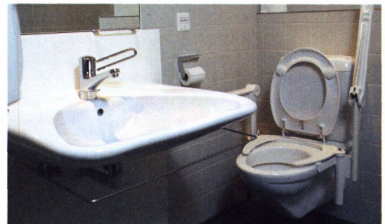
2 Beim Behinderten-WC wird das Neuste geboten: höhenverstellbare Einrichtungen.
