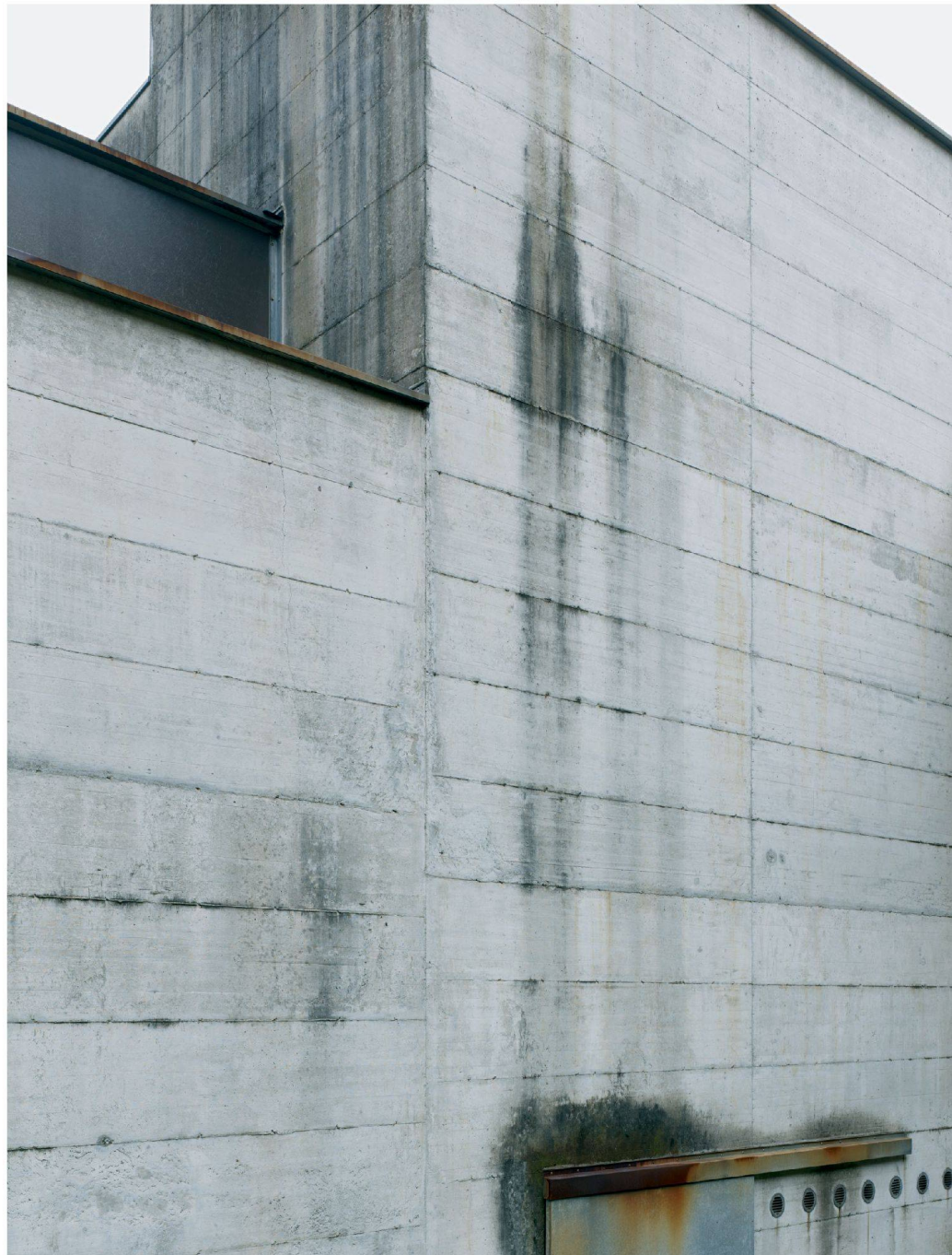
✓Zwanzig Jahre Dachwasser haben Spuren auf der rohen Betonfassade hinterlassen.
