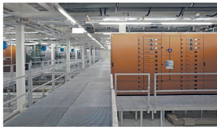
Installationsebene: Für den Fall eines Wassereintruchs stehen die Elektroanlagen auf Ständern. Foto: Marcelo Villada Ortiz
