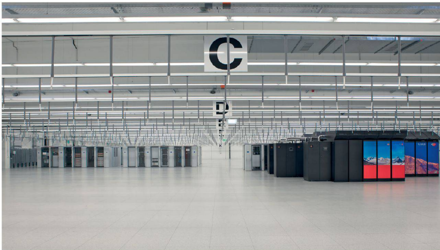
In der stützenfreien Halle für die Supercomputer hängen Rauchmelder von der Decke. Foto: Marcelo Villada Ortiz
