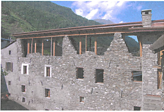
4 Die Steinfassade von 1682 wurde sanft renoviert. | The stone façade of 1682 has been gently renovated.
