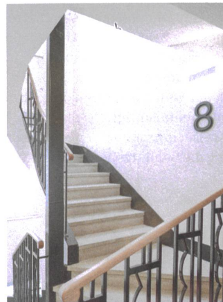
Das Geländer im Vordergrund ist nach altem Vorbild neu gearbeitet. In den 1970er-Jahren hatte man hier eine Wand eingezogen.
