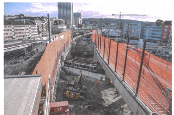
Bauphase 3: Eine schmale Inselbaustelle, durch die erst noch das Tram fährt – hier wird an der Brücke für die Gleise 5 und 6 gebaut.
