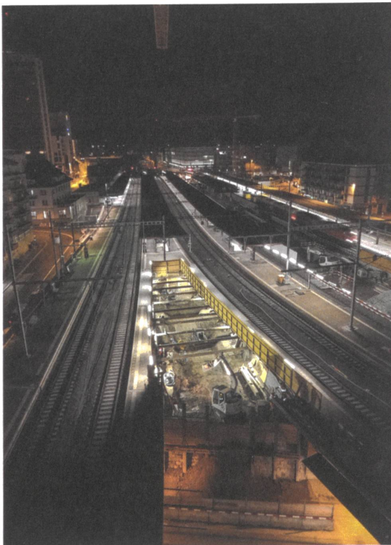
Bauphase 2: Zwischen der Walliseller Linie Gleise 1 und 2, links und dem Gleis 3 entsteht der Zugang Andreasstrasse.
