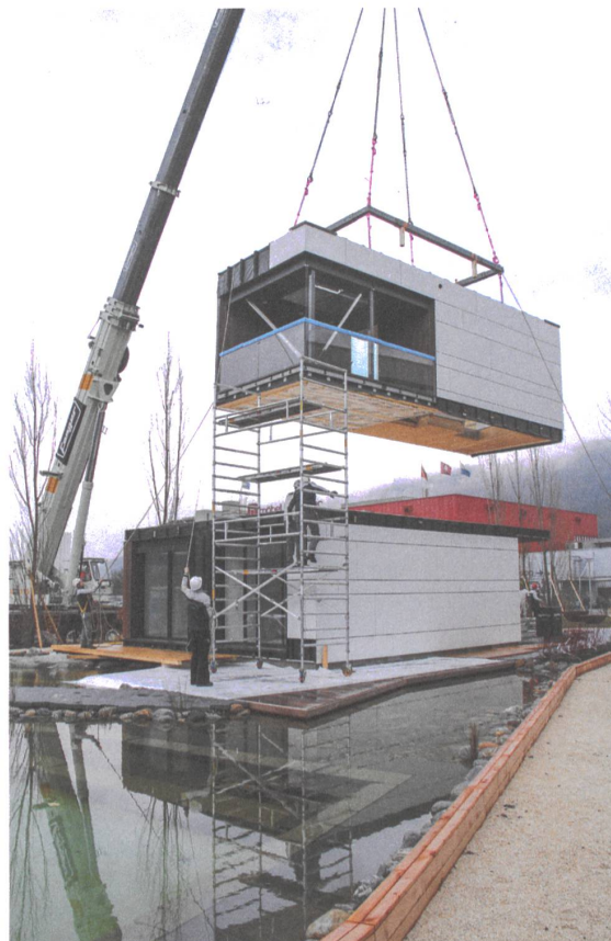
Danach wurde das Gebäude in Rothrist vor Ort zusammengesetzt. | Le bâtiment fut ensuite assemblé sur place à Rothrist. Foto | Photo: Renggli
