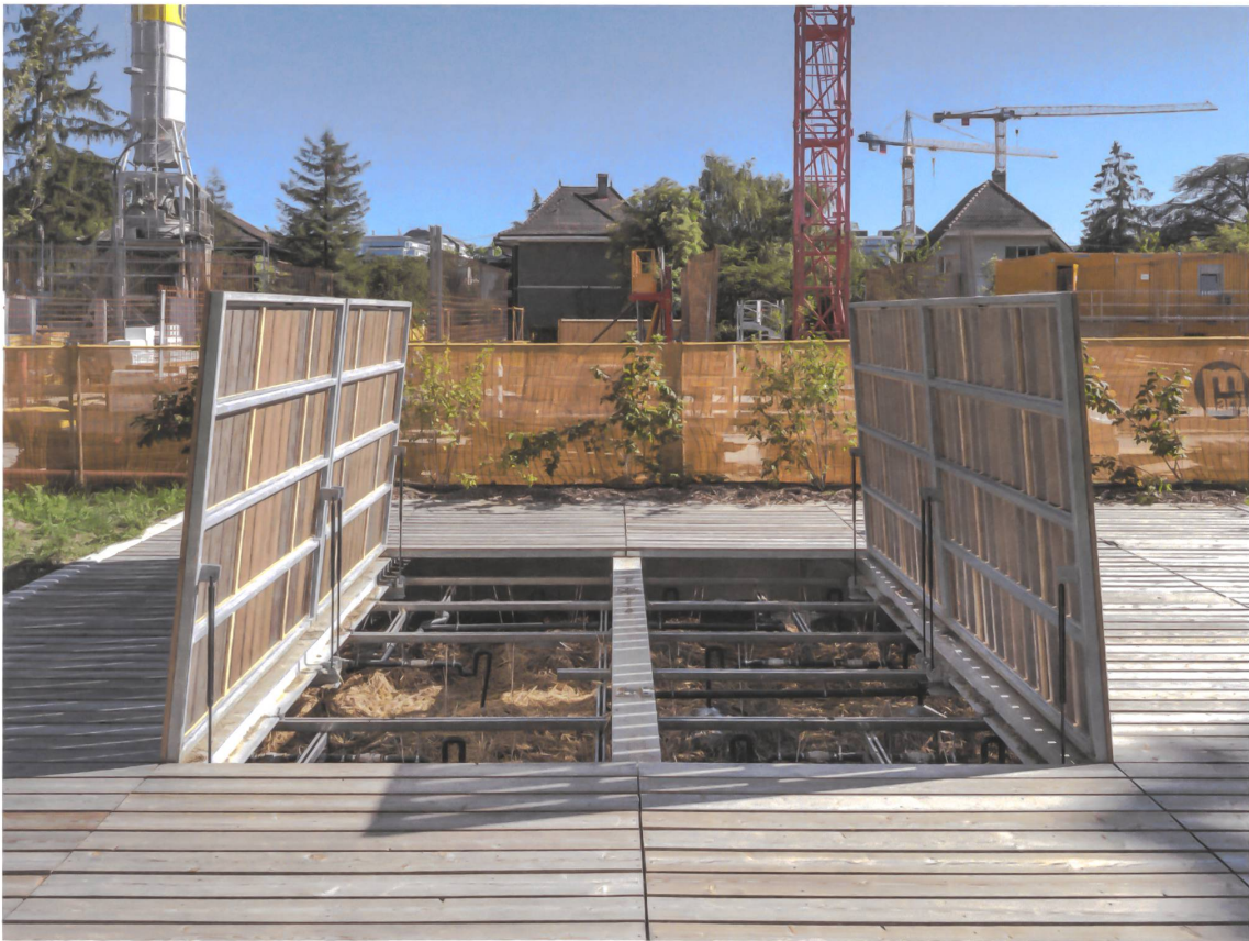
Da gärt was: Unter dem Gartensitzplatz verbirgt sich die Kläranlage, in der Würmer die Exkremente der Bewohner kompostieren.
