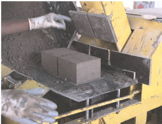
Fünf Arbeiter haben an der mobilen Presse die lose Erde in harte Ziegel verwandelt. Im Rahmen des Architekturvermittlungsprogramms «Chantier ouvert» haben an einigen Tagen auch Schulkinder Hand angelegt.
