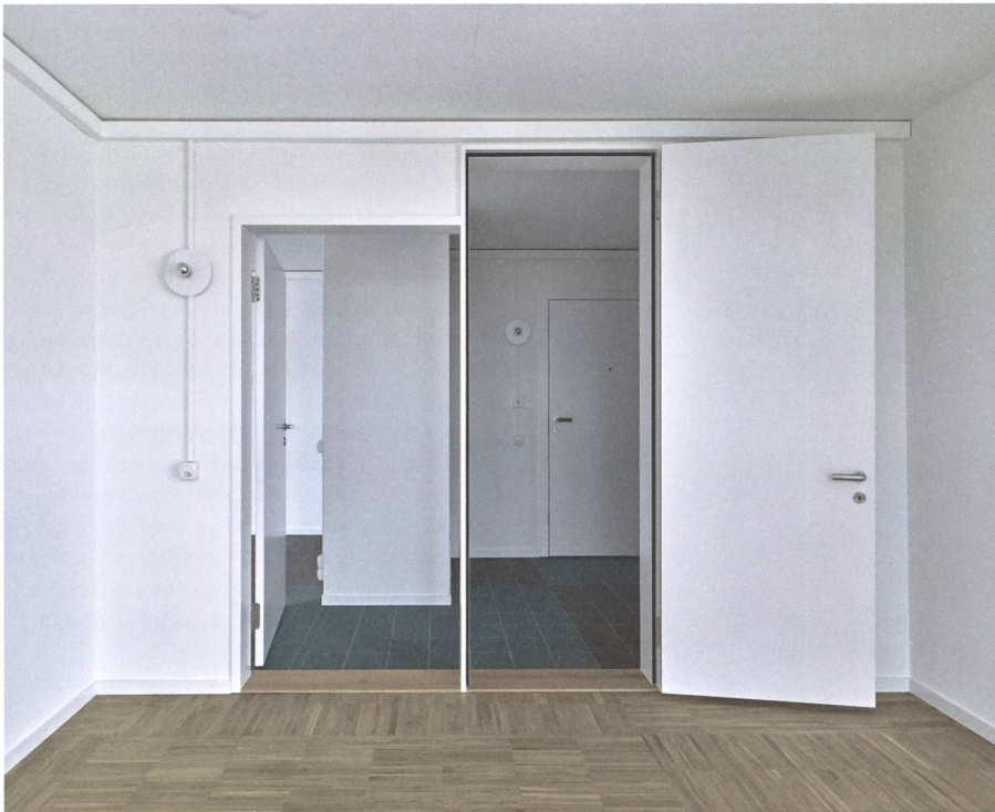
Offen geführte Elektroleitungen mit aufgesetzter Leuchte. Daneben: Türen mit Charakter.
