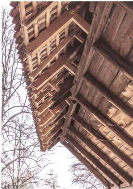
So einfach, wie die Handwerker einst die Rafen über den Kammeranbau spreizten, stützen neue Posten das gedämmte Dach von den Pfetten ab.
