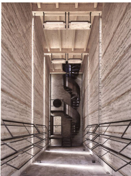
Eine Wendeltreppe führt am Ofen vorbei auf das Dach.
