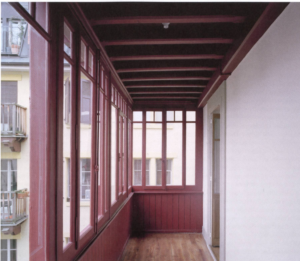
Les galeries des logements préexistants ne sont pas chauffées.
