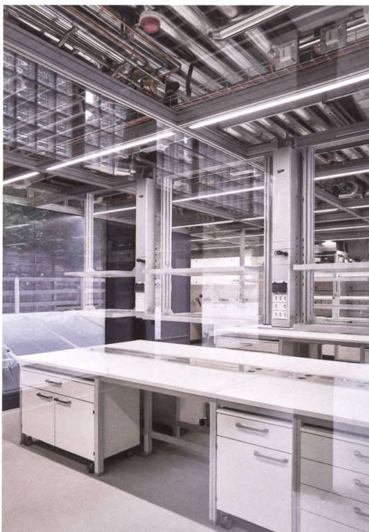
Im Labor sieht man vor lauter Leitungen die Decke nicht mehr.
