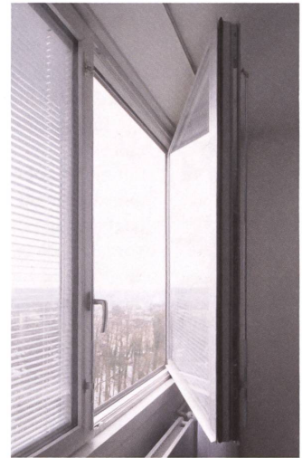
Zweischichtiges System: Die äusseren Alufenster sind erhalten geblieben. Die Holzfenster innen wurden durch neue mit Doppelverglasung ersetzt.
