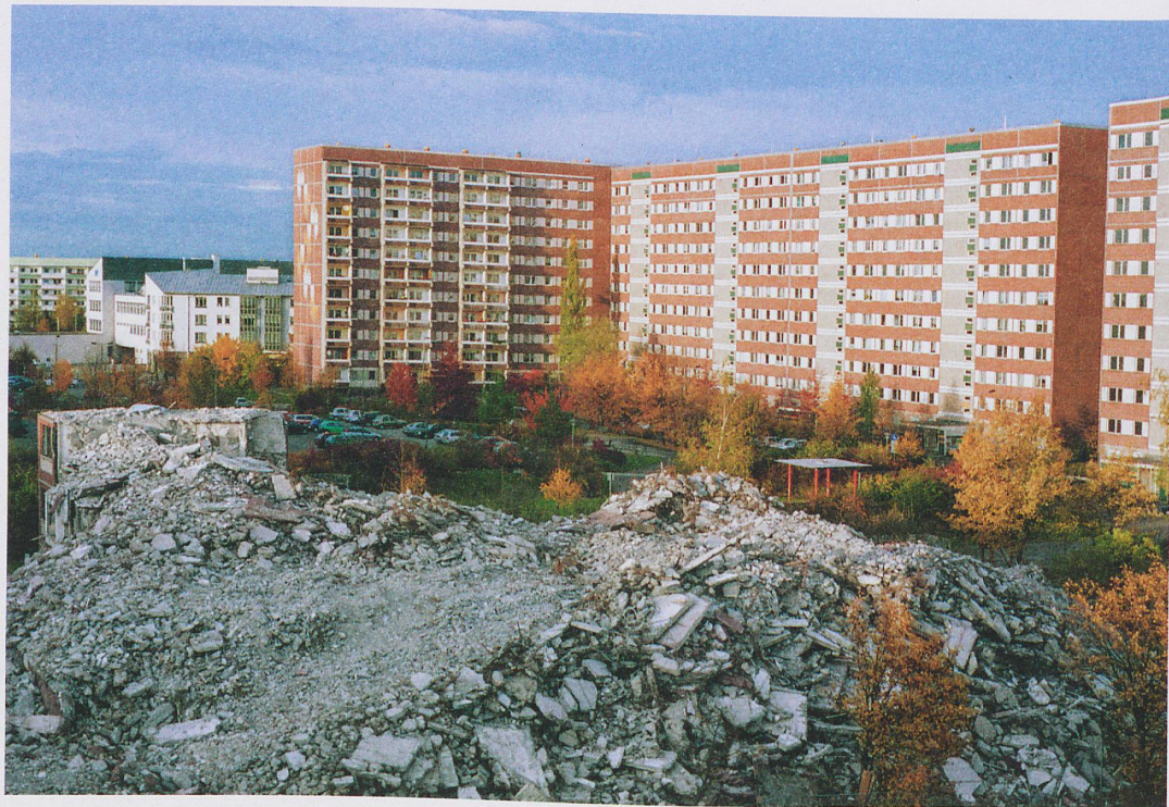
Des décombres d'un bâtiment à Leipzig. La ville a investi de façon ponctuelle dans la démolition de logements vides.
