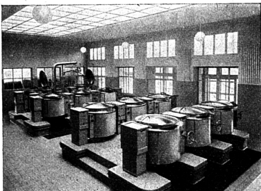
Grossküche mit 12 Thermo-Elektroden-Dampfkochkesseln von je 500 Liter Inhalt
