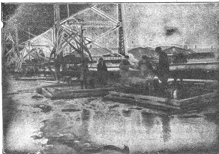
Verlegung eines Dückers aus Flanschenröhren von 600 mm I.W. in Klaraviken, Wasserleitung STOCKHOLM .
