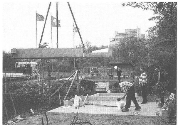
Abb. 14: Augst, Osttorareal (Grabung 1998.56), Befundzone 2 (Trakt für Esel und Futtervorräte). «Bauen über den Ruinen»: Das Verlegen der vorgefertigten Fundamentplatten auf die Micropfähle und die vorbereitete Humusschicht (im Vordergrund und Abb. 13).
