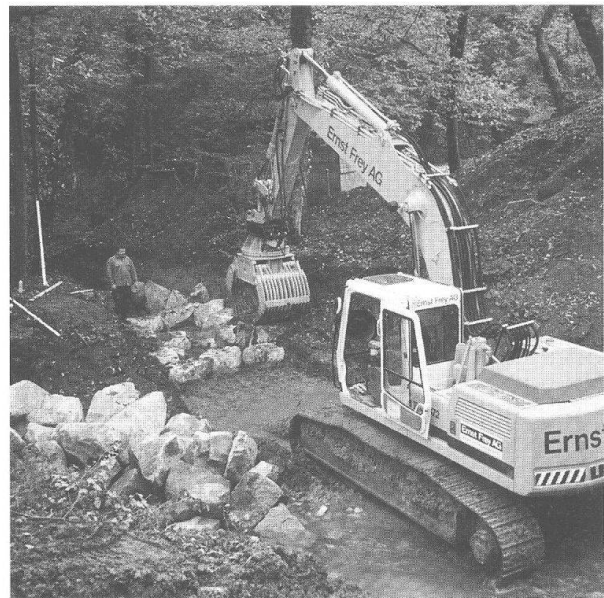
Abb. 44: Augst, Violenbach unterhalb des Osttores (Grabung 1998.56). Im Zusammenhang mit den Renaturierungsarbeiten am Violenbach wird eine Umgehungsrinne für die Fische errichtet. Blick gegen Osten.
