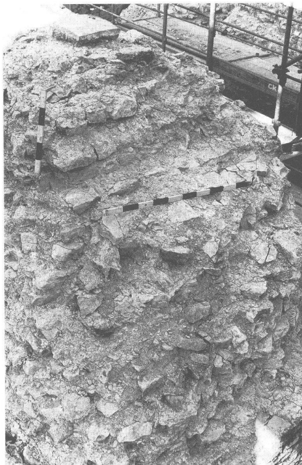
Abb. 4: Augst, Theatersanierung (Grabung 1998.55). Südaditus, westliche Bühnenmauer von Süden (MR 44). Nördliches Fenstergewände mit getreppt verlaufendem Widerlager des Fenstergewölbes. Vor dem unteren Teil der Abmauerung, wo der Massstab liegt, ist der Rest des Bettungskeiles für das Gewölbeaufleger zu erkennen.
