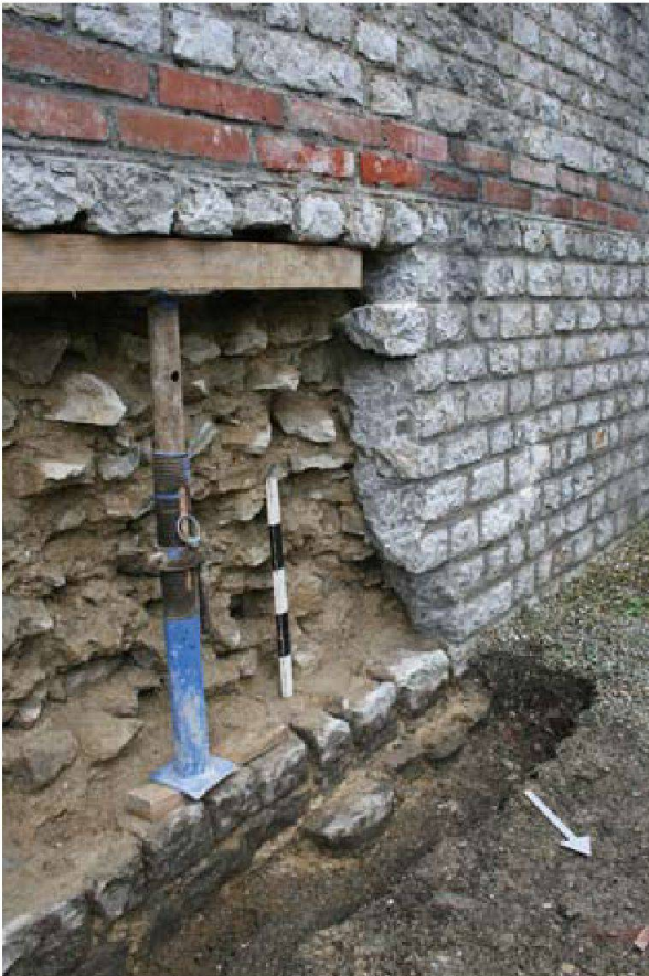
Abb. 40: Augst BL, Basilica (Grabung 2010.055). Ansicht an die Basilica-Stützmauer, nachdem die Mauerschale entfernt worden ist. Rechts ist nur noch eine dem antiken Mauerwerk vorgeblendete frühere Restaurierung erhalten. Im Graben am Fusse der Mauer ist das vorkragende Mauerstück zu erkennen.
