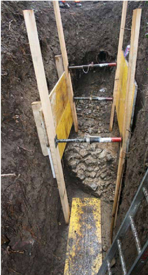
Abb. 36: Augst BL, Obermühle (Grabung 2010.054). Blick von Nordwesten an die im Abhang zur Ergolz zum Vorschein gekommene nördliche Gebäudeausenmauer MR 4.
