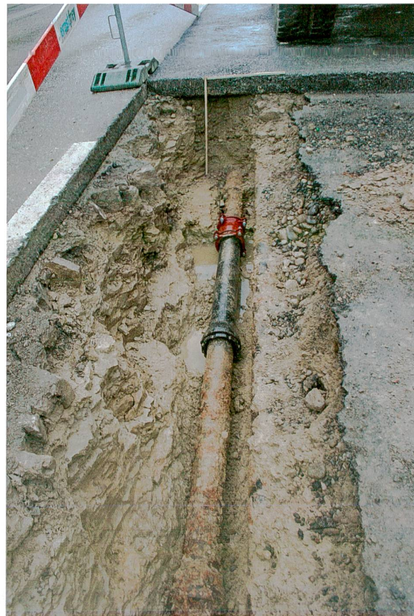
Abb. 53: Augst BL, Hauptstrasse Leitungsbrüche (Grabung 2013.066). Die vierte Bruchstelle (Feld 4) war schnell gefunden, da sie nur wenig weiter westlich lag als jene in Feld 3. Hinten oben die neu geteerte Fläche von Feld 3 (Abb. 52), wo die Leitung am Vortag repariert werden musste. Die Leitung liegt in einem aus dem anstehenden Fels heraus geschroteten Graben. Von Westen.
