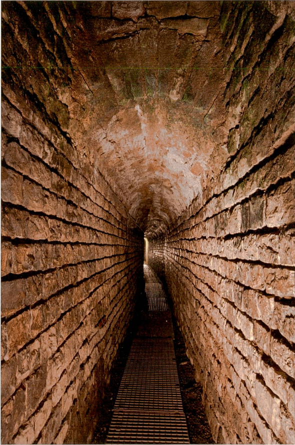
Abb. 28: Augst BL, Vermessung Keller und Kloake (Grabung 2013.061). Blick in die Kloake Richtung Osten. Deutlich ist der leicht gekrümmte Verlauf des Abwasserkanals zu sehen. Am oberen Bildrand ist die gemauerte Partie eines Einstiegschachts für Unterhaltsarbeiten zu erkennen.
