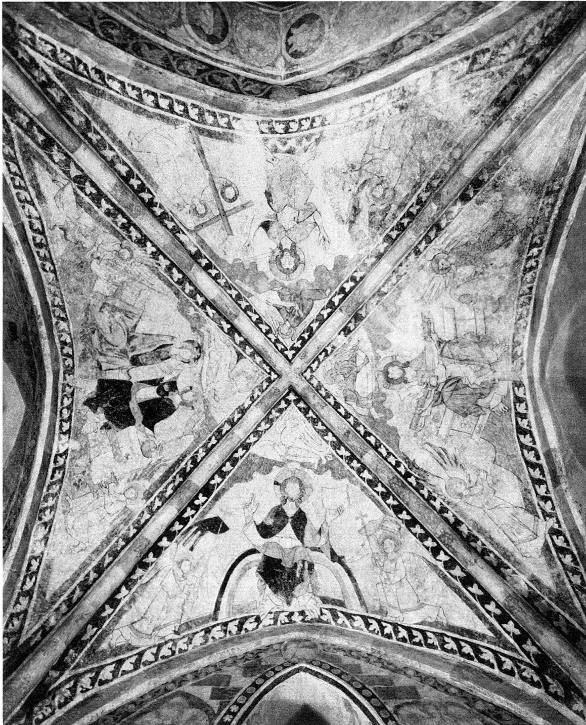
Unterkulm. Hochgotische Gewölbefresken im Chor der Pfarrkirche, frühes 14. Jh.; 1967/68 wiederentdeckt und restauriert
