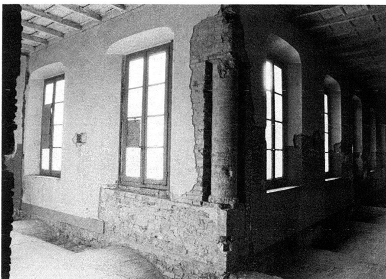
Fig. 3. Mendrisio, antico convento dei Serviti. Veduta parziale del primo piano durante i lavori di ricerca; la colonna d'angolo messa in luce porta incisa la data 30 ottobre 1588, ciò che dimostra l'esistenza della loggia ancora a quel momento
