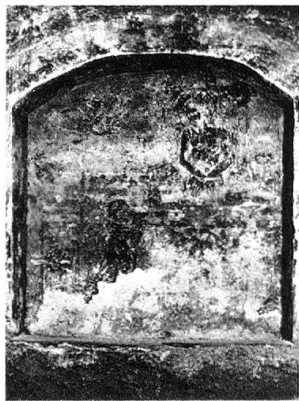
2 Messe de saint Grégoire, fresque, clocher d'Orsières. Etat avant restauration (1977).
