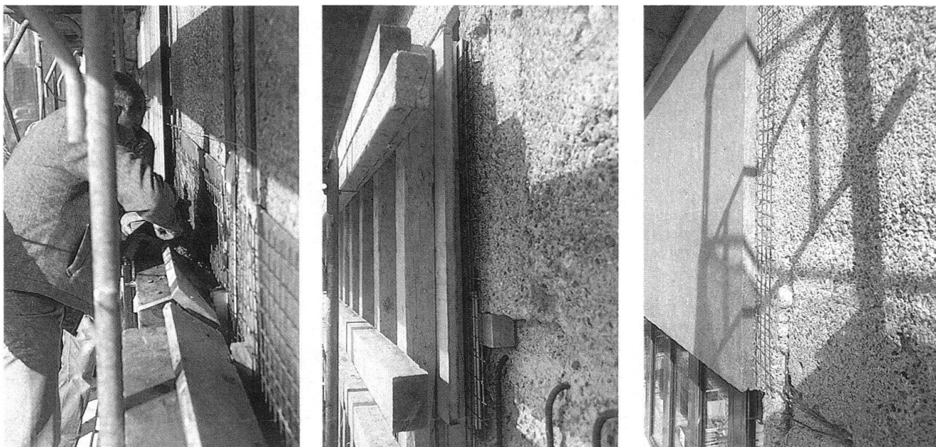
5-7 Verwaltungsgebäude der Städtischen Werke Baden. Montage der 6 cm dicken, neuen Betonschicht; die neue Betonwand bleibt sieben Tage lang eingeschalt; vorbetonierte Wand, Netzarmierung und alte Wand nebeneinander (fotografiert Juli 1987).
