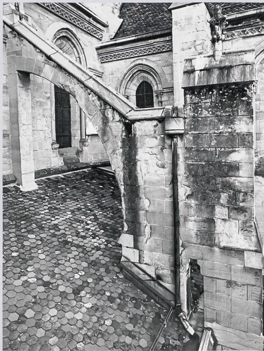
Etat de dégradation de l'arc-boutant 11 sud (photographie Claude Bornand, Lausanne, 2000)
